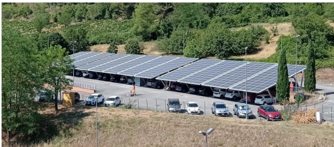
Figura 13. Carport Fotovoltaico realizzato da CET Ospedale di Poggibonsi, Azienda USL Toscana Sud Est
